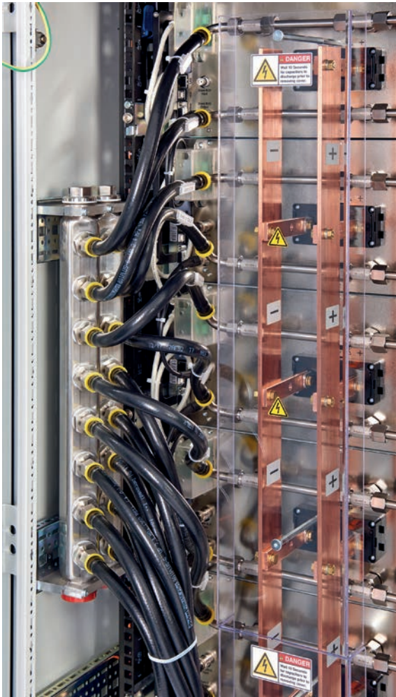
配 8 台设备以及水冷系统 (240kW 系统) 的机柜， 其水流分布与直流总线特写
